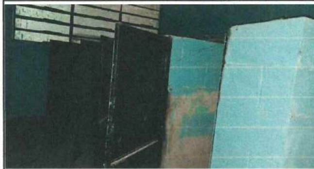
Foto 4: Las puertas de baños y aulas han sufrido daños con el paso del tiempo por lo que es necesario darles mantenimiento con una capa de pintura
