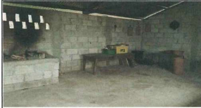
Foto 2: los muros de la cocina necesitan ser remozados y elevar la altura por el calor que se genera dentro, asi como sustitucion de piso, pintura y mejoramiento de la puerta de la cocina
